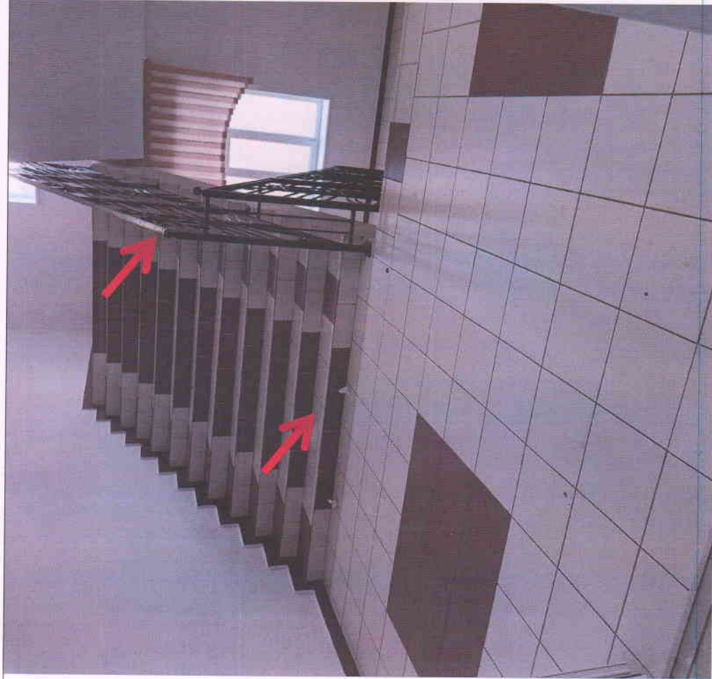
Фото № 9. Лестница, ведущая на верхние этажи. Поручень с одной стороны лестницы. Ступени контрастно не маркированы.
